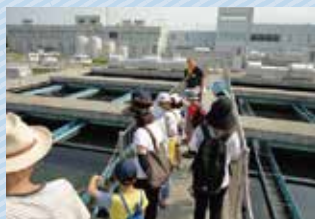
第十浄水場の浄水施設
